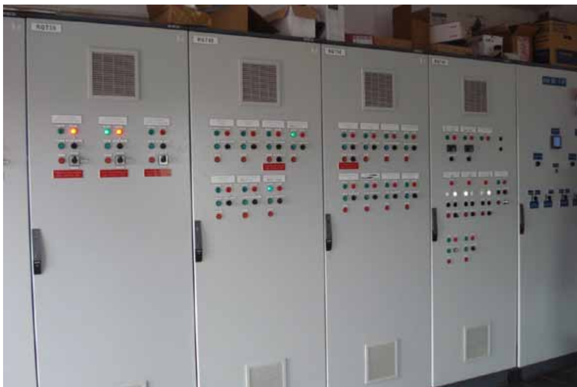
Foto: Szafy sterownicze urządzeń produkcyjnych
