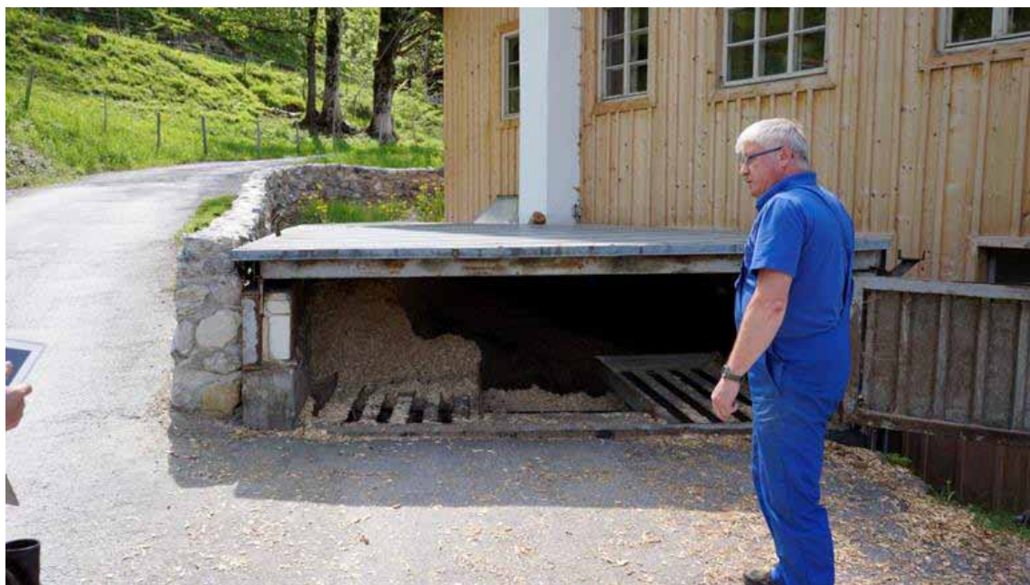
Foto: zsyp biomasy do kotłowni w hotelu Tannerhof
