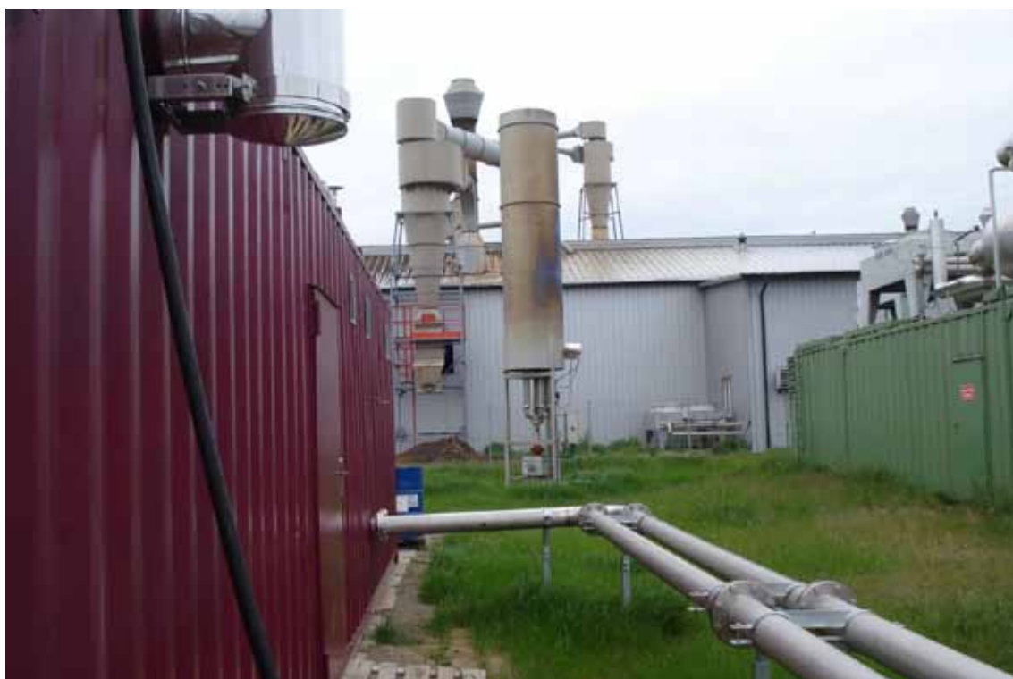
Foto: Tzw. świeczka – urządzenie do spalania nadmiaru wytwarzanego metanu np. w czasie przerw konserwacyjnych
