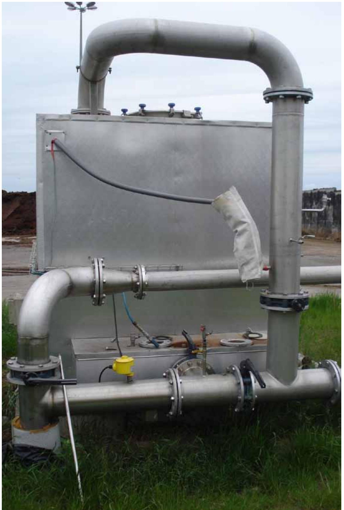
Foto: Instalacja do odsiarczania metanu
