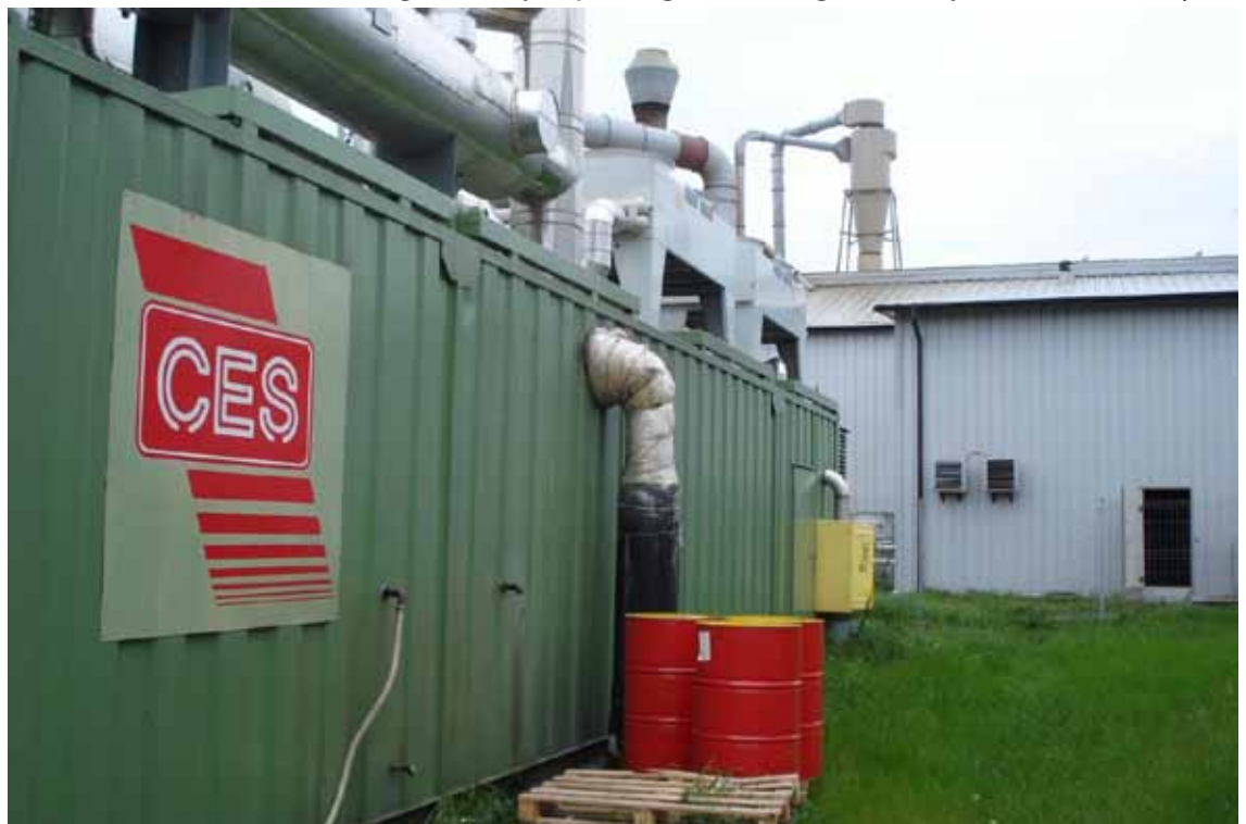
Foto: Agregat kogeneracyjny
