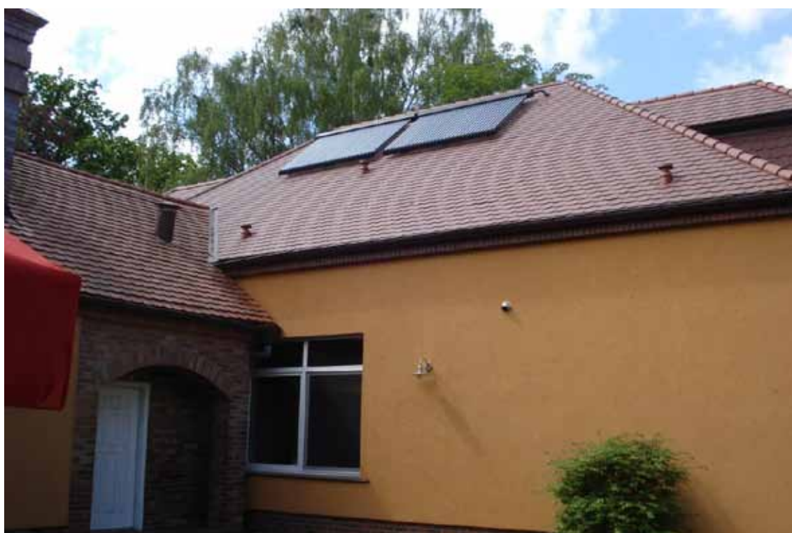
Foto: na południowym dachu części gospodarczej Pensjonatu zamontowano rurowe kolektory słoneczne.
