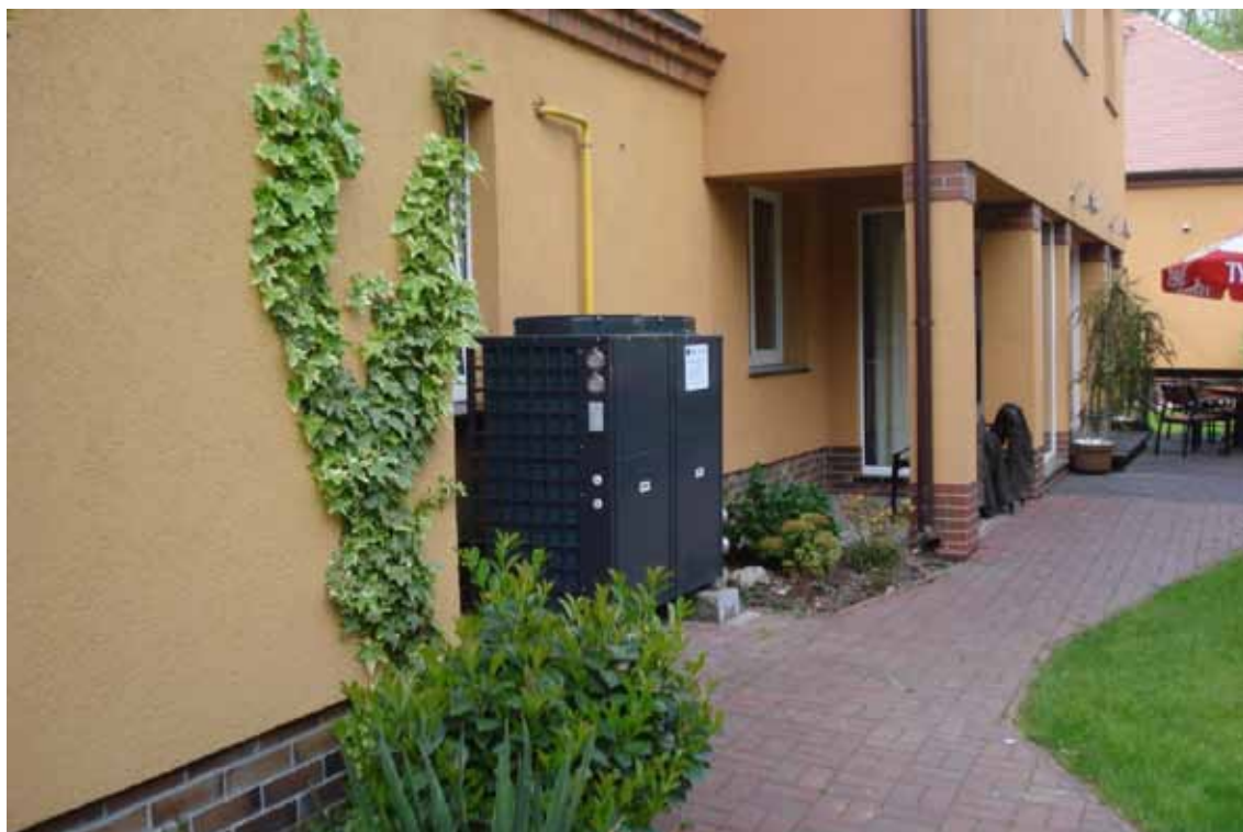
Foto: w części ogrodowej na tylnej ścianie budynku Pensjonatu jest usytuowana pompa ciepła
