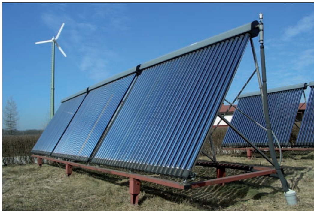
ZD Żerniki Wielkie - kolektory słoneczne i generator wiatrowy
