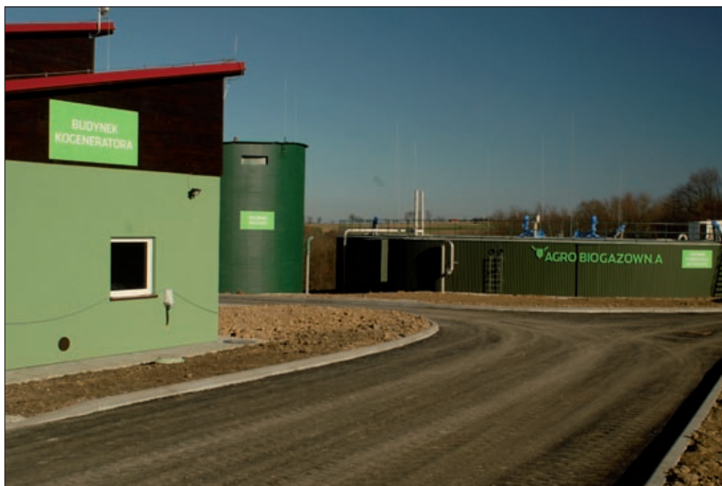
ZD Grodziec Śląski - Agrobiogazownia (kogenerator, zbiornik biogazu, reaktor fermentacyjny)
