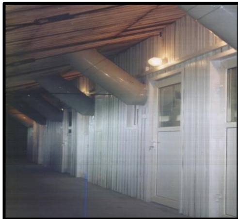
Fot. 1. Komory klimatyczne 1, 2, 3 (fot. Jacek Walczak)
